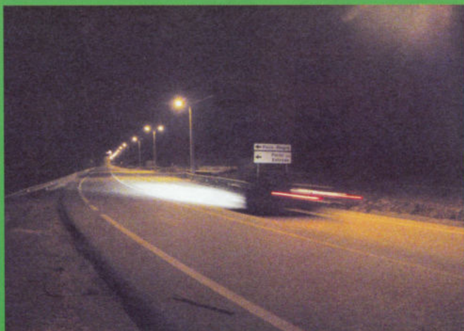
Instalação de ramal de iluminação na estrada este de Figueiró dos Vinhos, do IC8.
