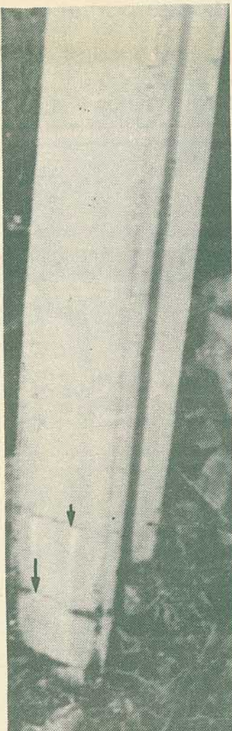
O poste rachado na base: uma ameaça!
