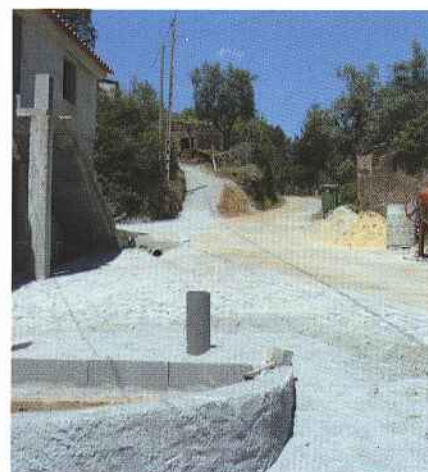
Prosseguem os trabalhos de execução de arruamentos em calçada na freguesia de Campelo.
