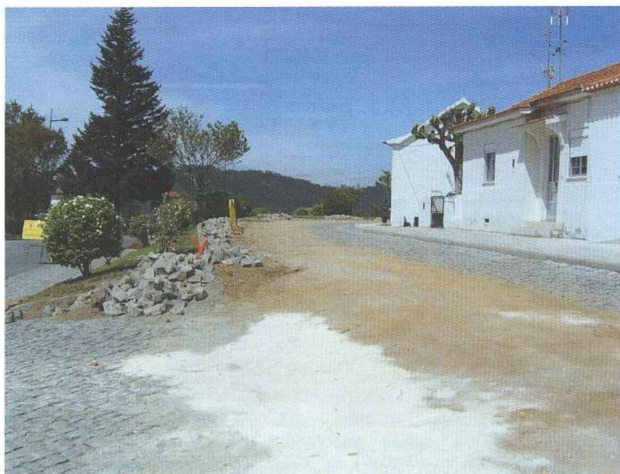
No Bairro Municipal estão em curso obras de Beneficiação das Estruturas de Iluminação Pública.
