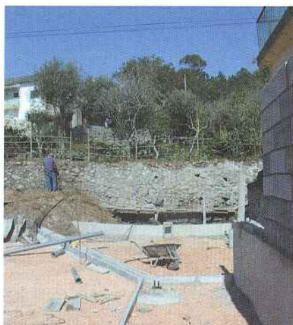
Proseguem em bom ritmo de execução as obras do Arranjo Paisagístico no Douro.
