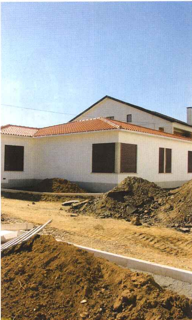
Edifício de Apoio ao Corpo Activo da Associação Humanitária dos Bombeiros Voluntários de Figueiró dos Vinhos, obra em fase de conclusão e que a Câmara Municipal apoiou desde o seu início.
