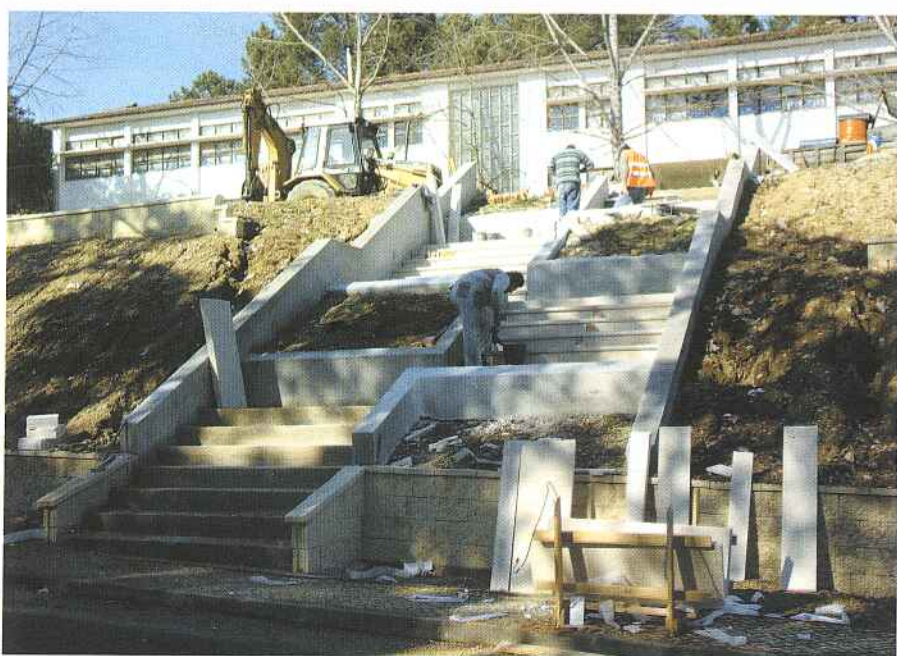
A entrada da Vila junto dos Mações e da Pedreira ficará servida de zonas ajardinadas, de lazer e de estacionamento na sequência das obras de requalificação do Antigo Campo da Mocidade.
