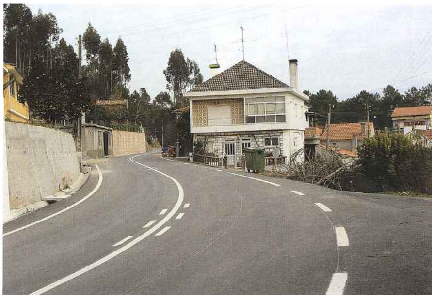
Encontra-se praticamente concluída a obra de Alargamento, Rectificação e Beneficiação da Estrada Municipal n.º524 do N6 IC8 a Chimpeles e da Estrada Municipal 1131 de Chimpeles a Moninhos Cimeiros, investimento de cerca de 661.209,00 Euros.
