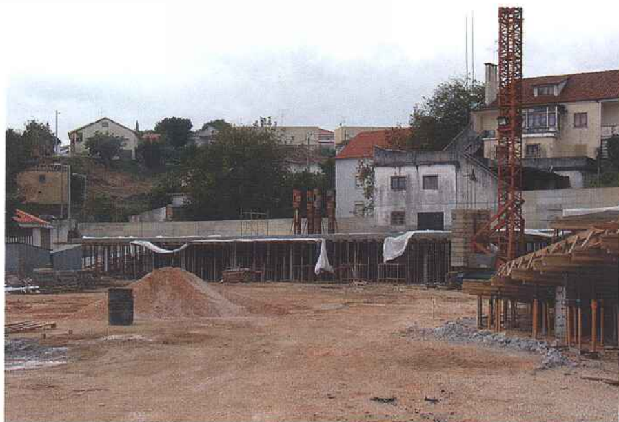
Obra de grande dimensão no tecido urbano da Vila; a construção do Parque de Estacionamento junto ao Palácio da Justiça, com cerca de 124 lugares, virá aumentar a oferta de estacionamento numa zona de serviços.
