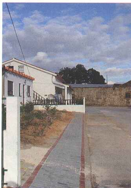
No Bairro Pré-Fabricado prosseguem obras de Beneficiação de passeios e pavimentos depois de ter sido intervencionada a rede de Iluminação Pública.
