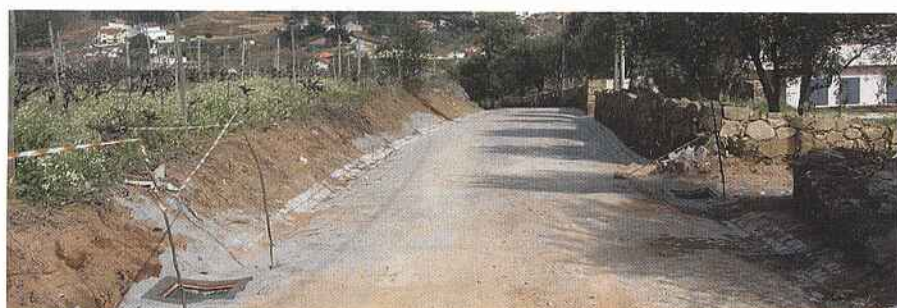
Drenagem de águas e reposição de calçadas em Fonte do Velho, importante investimento, contribuindo para a resolução de uma grave situação.
