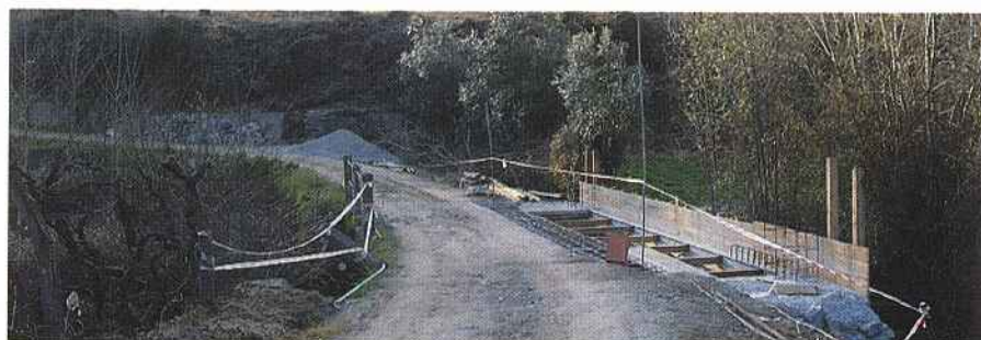
Alargamento da Ponte da Telhada, obra fundamental para o prosseguimento da obra de construção do Caminho Agrícola Telhada/Branquinho.
