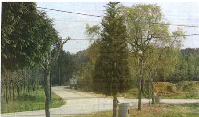
Na Avenida do Campo de Futebol foram já instalados cabos subterrâneos para instalação de novas colunas a que se seguirá a instalação de novos Candeeiros.
