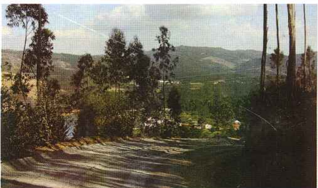
Beneficiação da Estrada Municipal 1145 do Vale do Prado a Foz de Alge, obras de valor superior a 93.282.00 euros, um investimento estruturante para a freguesia de Arega.
