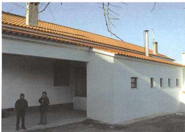
Obras de construção do Centro de Actividade e Tempos Livres (ATL) em Arega
