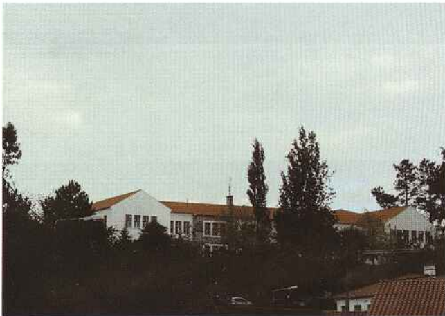
Escola do 2º Ciclo de Figueiró dos Vinhos Obras em fase de conclusão
