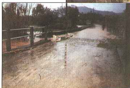
A ponte do Bairro, recentemente alargada, esteve submersa pela enxurrada.
