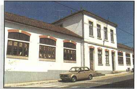
A Câmara está a proceder a obras de restauro de uma antiga residência escolar para acolher a sede do Projecto de Luta Contra a Pobreza, após ter conhecimento da sua aprovação.
