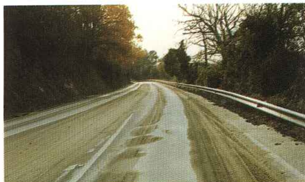
Estrada 237, próximo de Aldeia Ana de Aviz e do IC 8 (cuidado com este pavimento).
