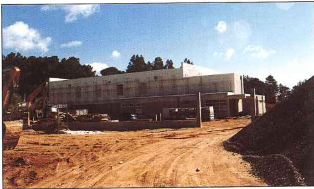
Polidesportivo coberto em construção junto à Escola Secundária de Figueiró dos Vinhos
