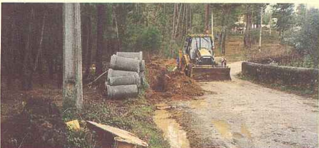
Drenagem de Caminho Municipal
