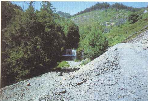
Defesa da Floresta. Além de reservatórios em betão, procede-se também à construção de acessos a pontos de água para abastecimento de viaturas e meios aéreos.
