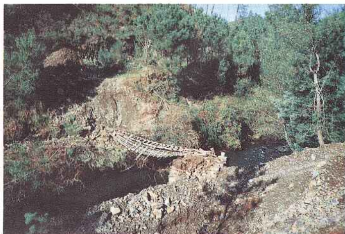
MACHUCA - Trabalhos de preparação para a construção da Ponte sobre a Ribeira de Alge
