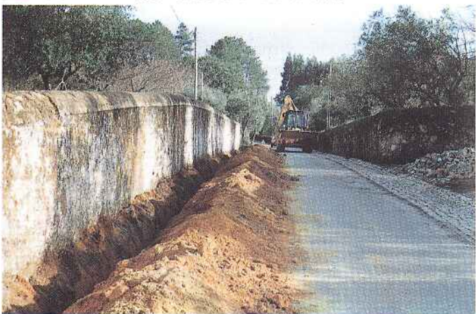
Abastecimento de Água: 20% do Concelho em 1989 - 70% em 1993
