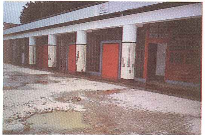
Devido às chuvas, não foi possível acabar o pavimento antes das aulas
