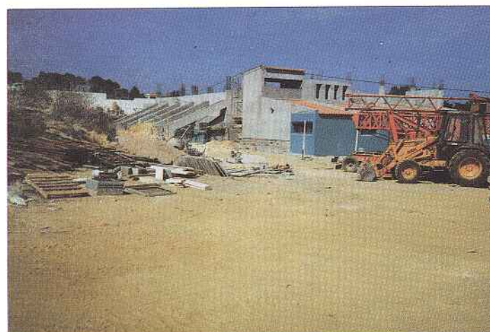
Área da Casa das Máquinas.
