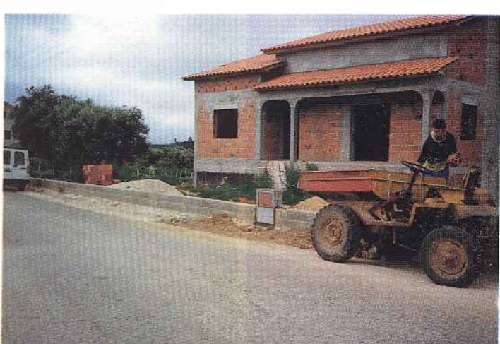
Abastecimento de Água (Ligações finais às habitações)
